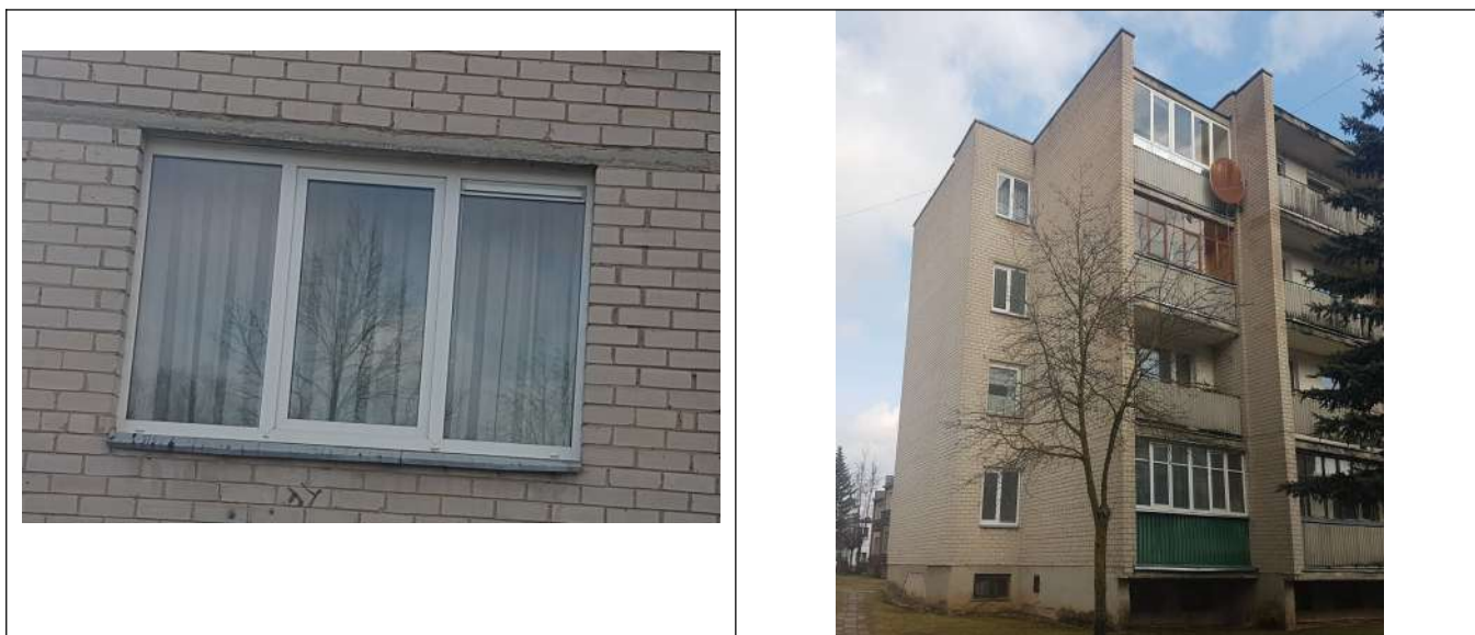
Paveikslas 1. Nuotraukose matyti esamos išorinės sienos, pažeidimų nenustatyta. Išorės palangių apakrdinimas aprūdijęs.
