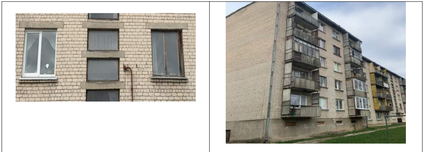
Paveikslas 1. Nuotraukose matyti esamos išorinės sienos, pažeidimų nenustatyta. Išorės palangių aspakrdinimas aprūdijęs.
